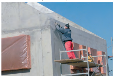
Isolation PUR, 20 à 25 cm épaisseur
